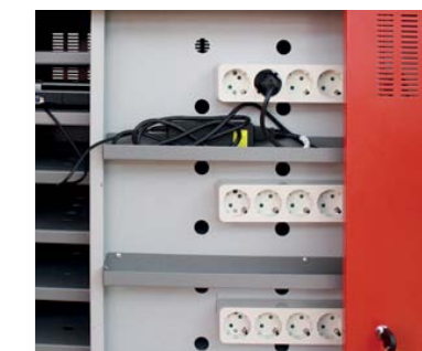
Armazenamento de transformadores Almacenamiento adaptadores AC
